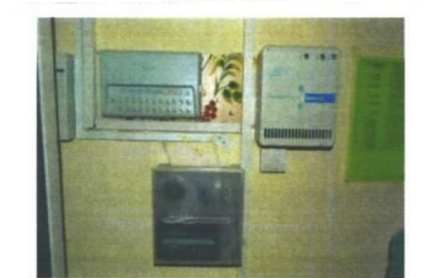
Фото № 18 - Акустическая система оповещения о пожаре
