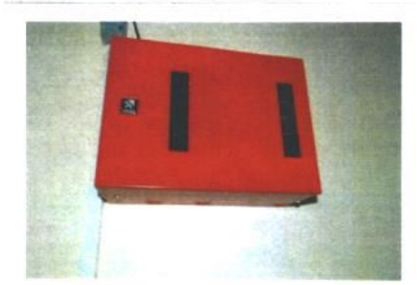
Фото № 17 - Акустическая система оповещения о пожаре
